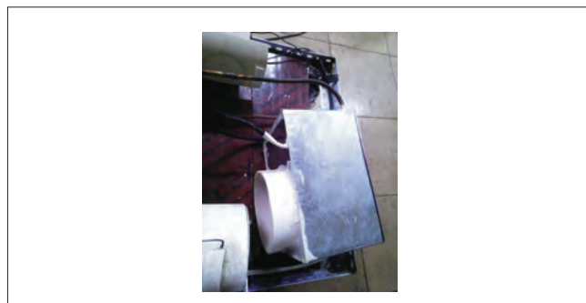
图5 升温降温风道
